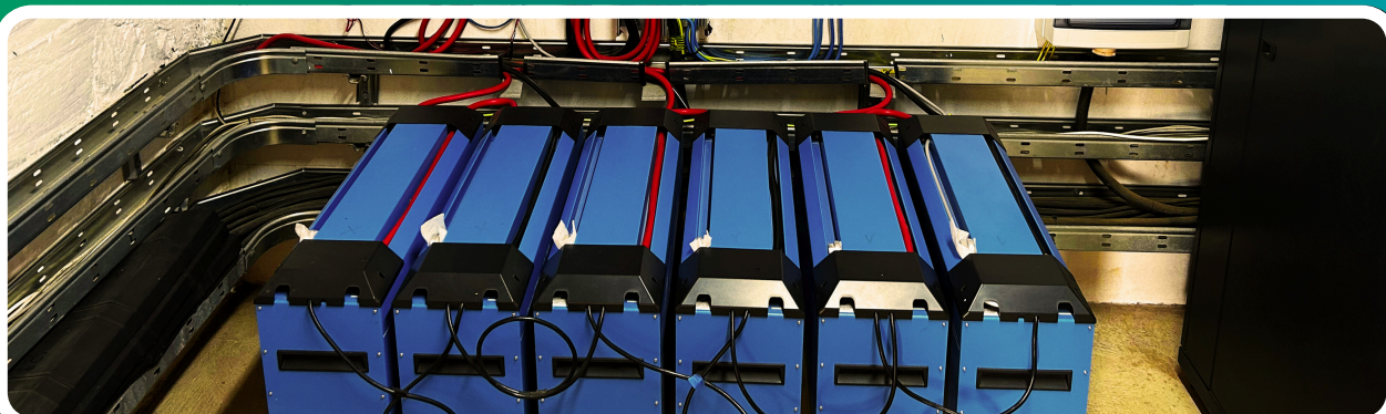
BATERIAS DO SISTEMA DE MICROPRODUÇÃO INSTALADAS INSTALLED MICROPRODUCTION SYSTEM BATTERIES
