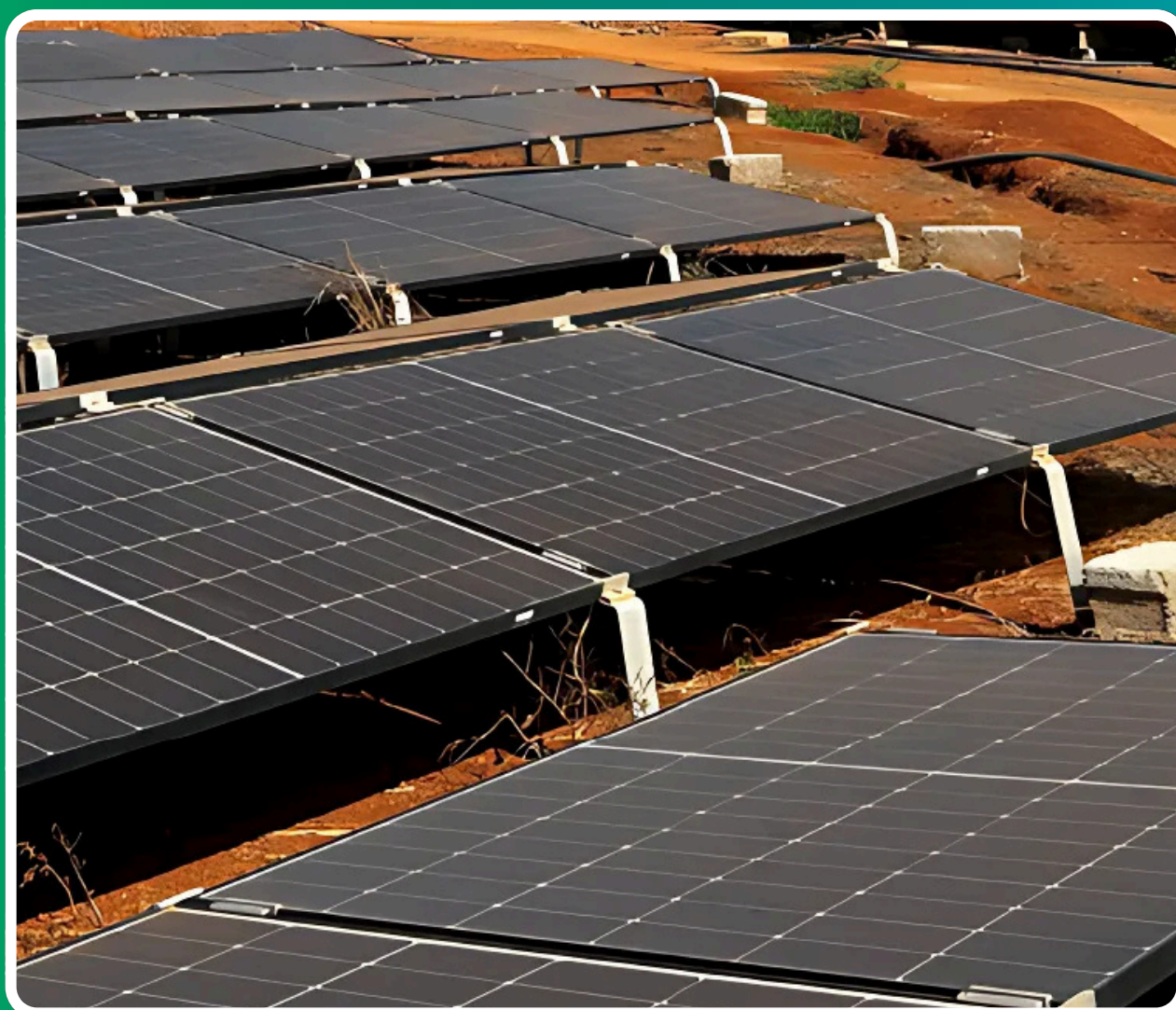
SISTEMA SOLAR FV INSTALADO SOLAR PV SYSTEM INSTALED
