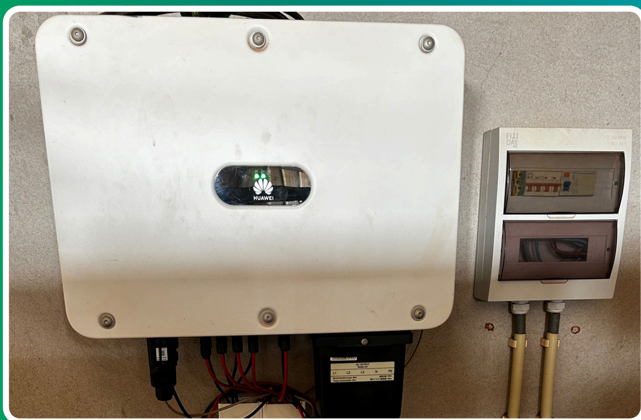
QUADRO ELÉTRICO E EQUIPAMENTOS DO SISTEMA SOLAR FV ELECTRICAL PANEL AND SOLAR PV SYSTEM EQUIPMENT
