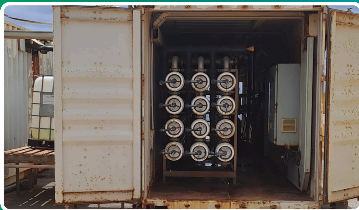
ESTAÇÃO DESSALINIZADORA DE PREGUIÇA PREGUIÇA DESALINATION PLANT
