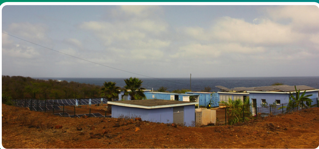
INFRAESTRUTURA GERAL DA DESSALINIZADORA E O SISTEMA SOLAR FV INSTALADO
