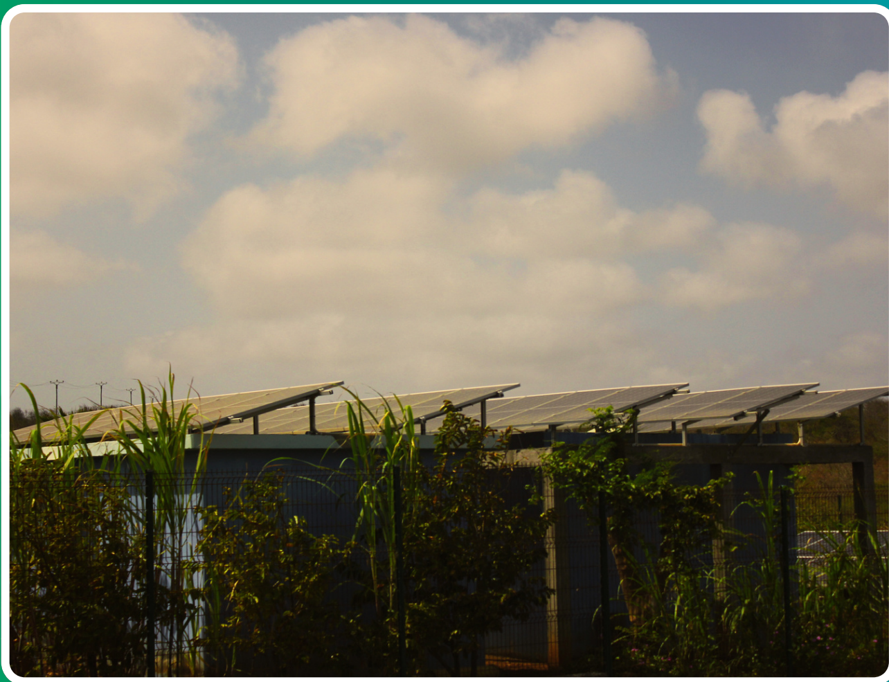
SISTEMA SOLAR FV INSTALADO E EM FUNCIONAMENTO SOLAR PV SYSTEM INSTALLED AND IN OPERATION
