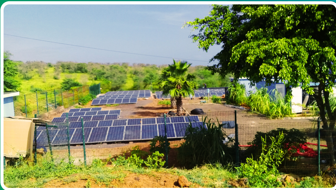
SISTEMA FV INSTALADO EM FUNCIONAMENTO PV SYSTEM INSTALLED AND IN OPERATION
