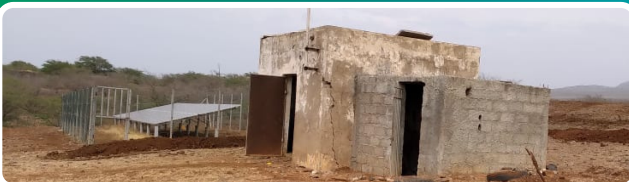
FASE DE INSTALAÇÃO DO SISTEMA SOLAR FV ANTES DAS OBRAS DE REABILITAÇÃO INSTALLATION PHASE OF THE SOLAR PV SYSTEM BEFORE REHABILITATION WORKS
