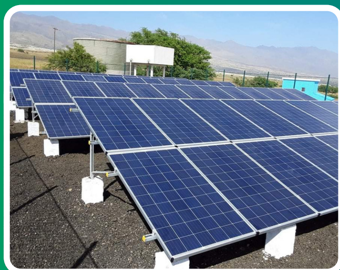
SISTEMA SOLAR FV INSTALADO SOLAR PV SYSTEM INSTALED
